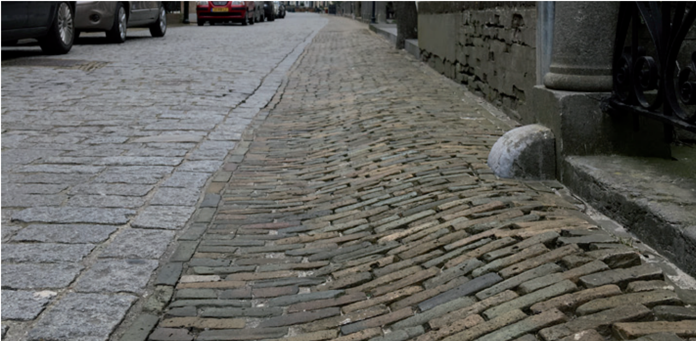
ernstig verzakte bestrating in granietkeien en ijselsteentjes. De schampstenen blijven bij herstel behouden.
