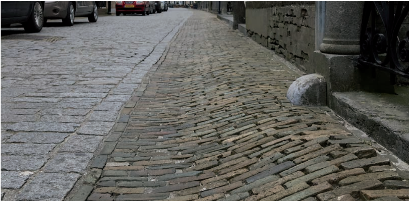
ernstig verzakte bestrating in granietkeien en ijsselsteentjes. De schampstenen blijven bij herstel behouden.
